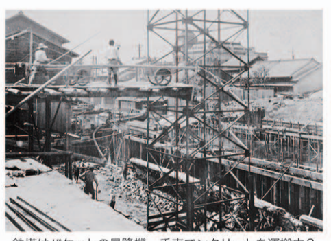
鉄塔はバケットの昇降機 手車でコンクリートを運搬中?
