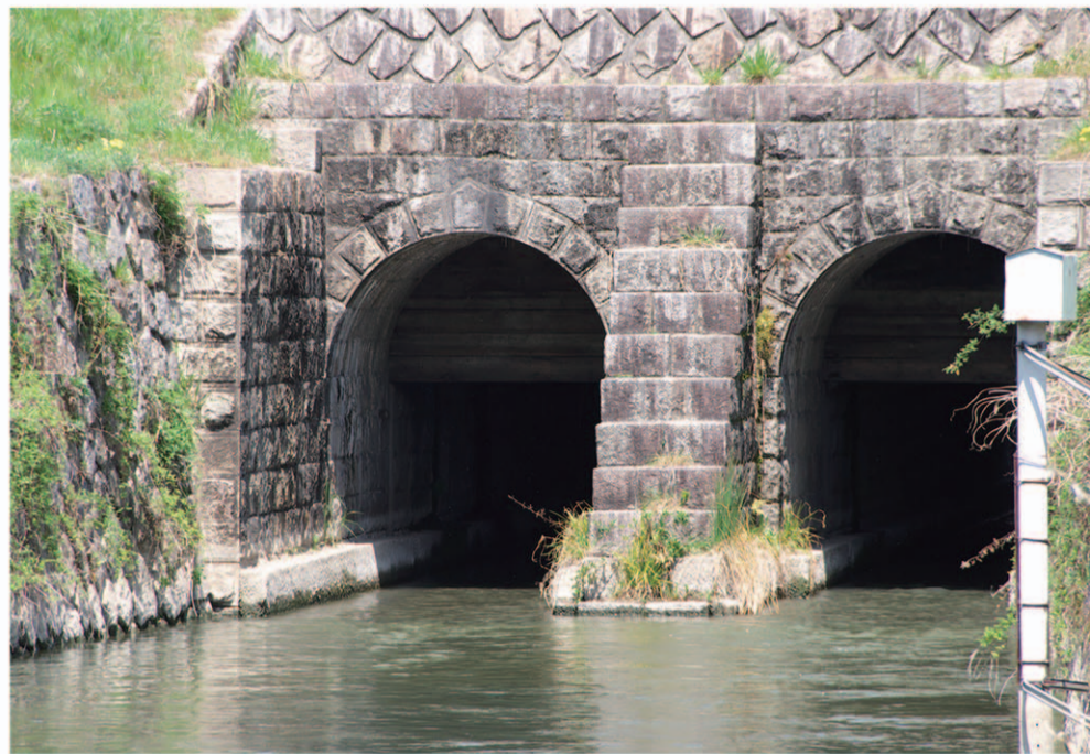
庄内用水元杵樋門出入口（南側） 西側(左)のトンネル口に鉄の環 上部胸壁の目地は人造石工法の特徴を示す
