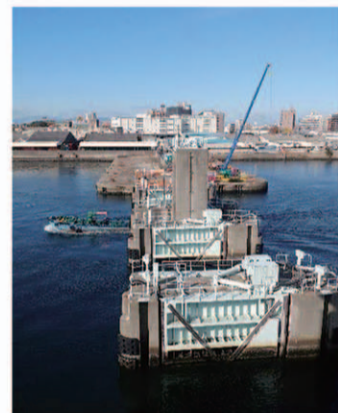
横から見た水門と船の通航の様子 ▶
